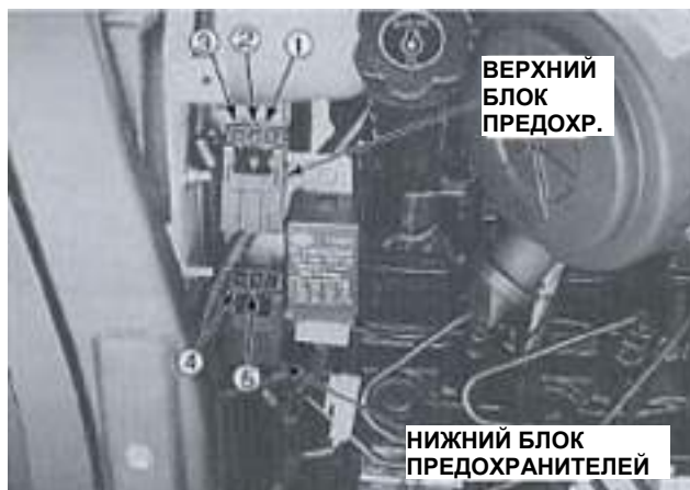
Рис. 71. Главные блоки предохранителей
